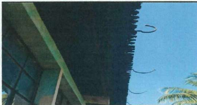
Foto 6: laminas y canales deterioradas
