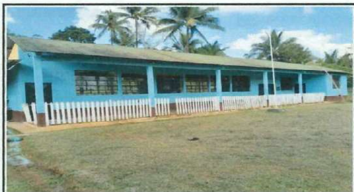
Foto 3: cambiar barandas por celosia de concreto.
