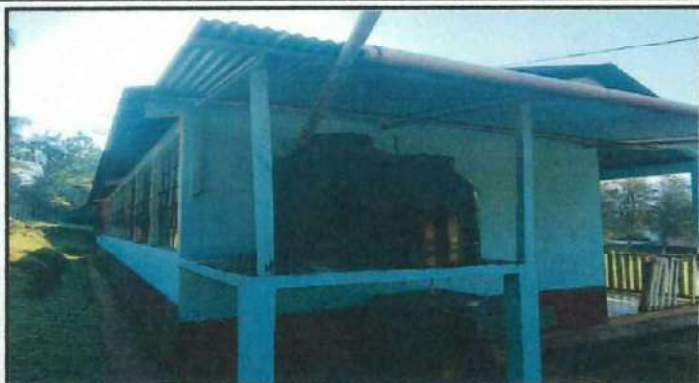
Foto 1: Canales y bajada de agua Pluvial
