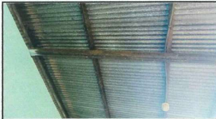
Foto 2: costaneras oxidadas en mal estado
